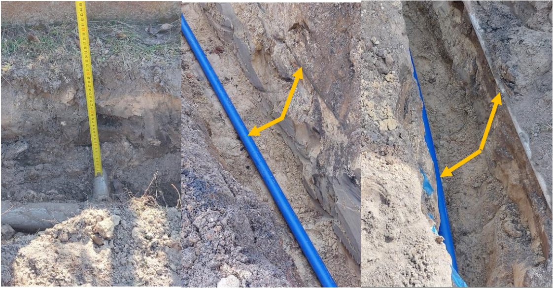
Rys. 2. Zbyt płytko ułożone rurociągi
